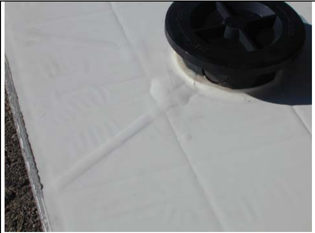
Herstellerproblem, kalte Lötstelle, Einzelfall
